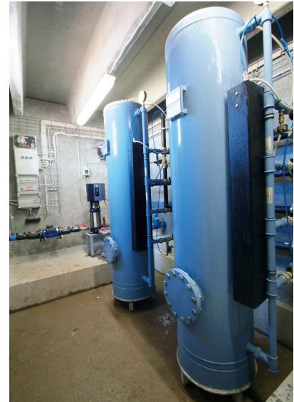
En lang række ejendomme og boliger er beliggende, således at tilslutningen til et større og fælles vandværk ikke er hensigtsmæssigt eller ønskeligt. Den vandbehandlingstekniske løsning hertil tager naturligvis udgangspunkt i de samme grundprincipper som ved de større vandforsyninger. Et trykfilteranlæg type NSB er ideelt til små og mellemstore drikkevandsforsyninger.
