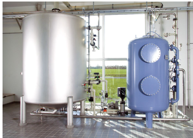
Afblæsning af opløste gasser såsom aggressiv kulsyre, metan og svovlbriente er en forudsætning for en optimal filtrering. Foto: Afblæser og overfladebehandlet trykfilter på dansk bryggeri.
